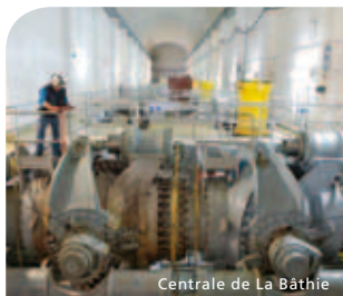
Centrale de La Bâthie
