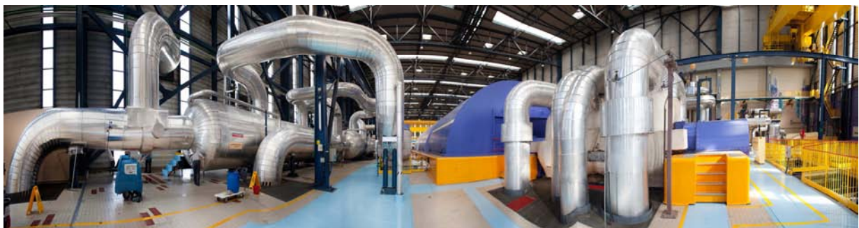
Vue d'une des salles des machines de la centrale nucléaire de Bugey.
