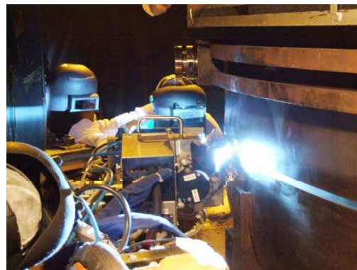
Soudage du joint final reliant la partie supérieure et la partie inférieure d'un générateur de vapeur.
