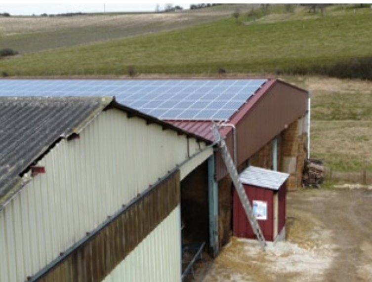
Panneaux photovoltaïques sur un hangar agricole à Annonville (52)
