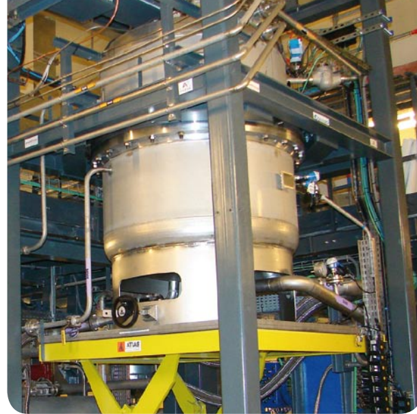
Cuve de mélange sodium-soude
