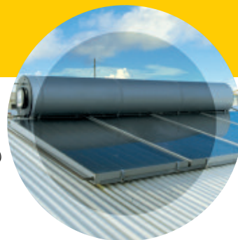
Chauffe-eau solaire à Grande Terre (Guadeloupe)
