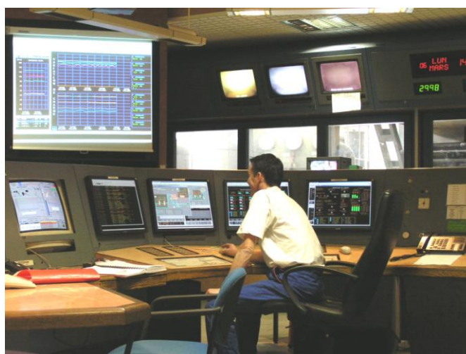
>Une des trois salles de commande de la centrale
